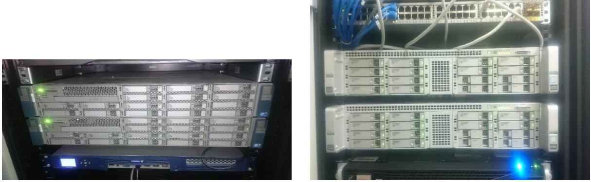
صور توضح سيرفرات الهاتف الشبكي
